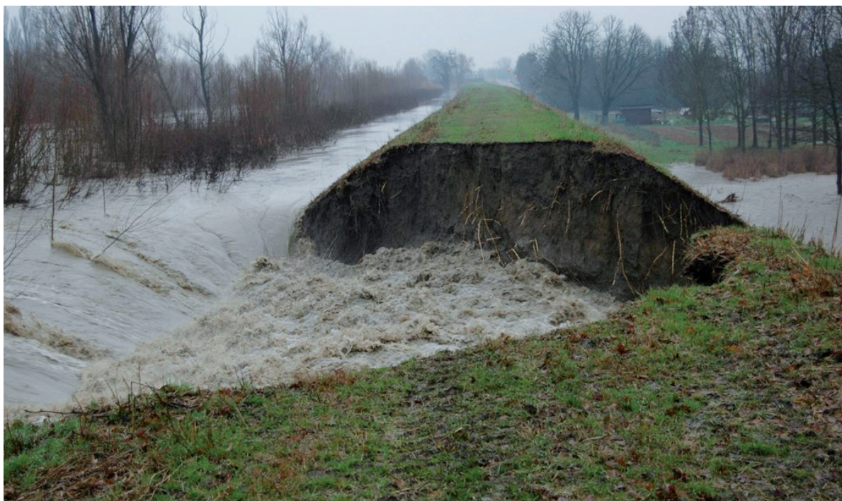
Figura 10. La rottura dell'argine del fiume Secchia nel 2014 (foto AIPo)
